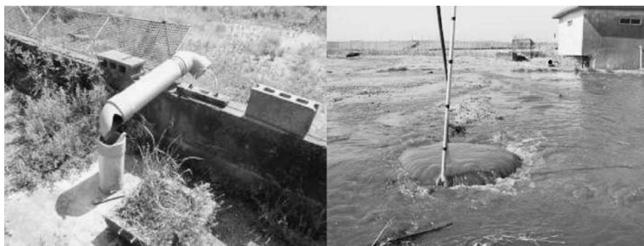
写真 2 内水面支場の破断した配管と液状化の状況
